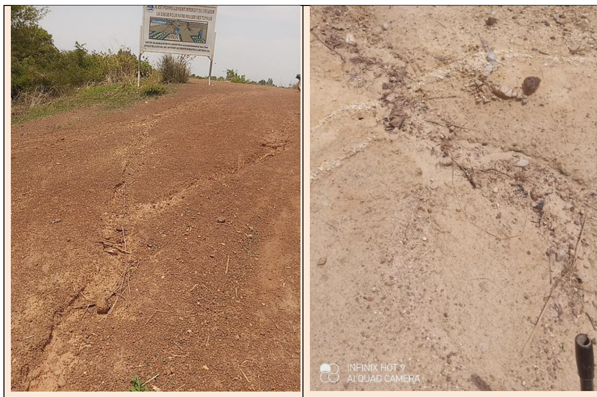
Image 2 : l'érosion en rigole
